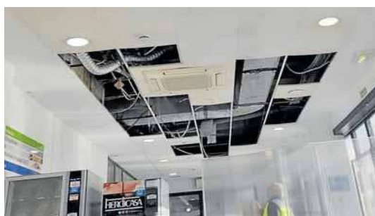
Estado de alguno de los techos del centro deportivo. E. C.
