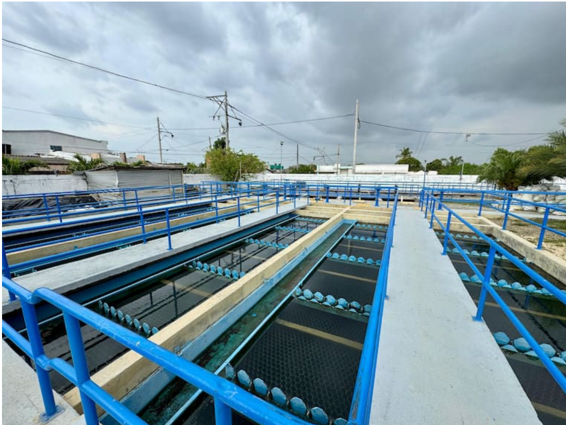
Demoras en la recepción de suministros han impedido la culminación de los trabajos en la planta.
